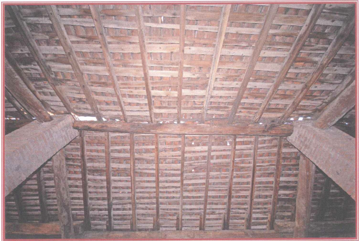
Figura 10 Tetto del fienile sopra le stalle. Da notare la trave di colmo bagnata dalla pioggia per l'assenza dei coppi del colmo.
