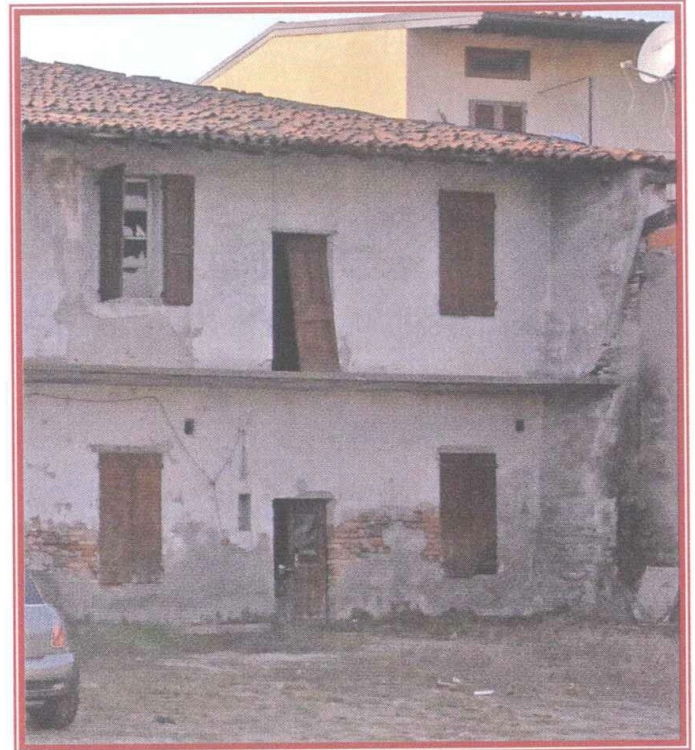
Figura 2 Vista dell'intonaco degradato per un'altezza di circa due metri.
