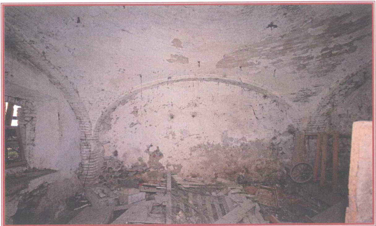
Figura 8 Volta delle stalle. Da notare gli evidenti distacchi degli strati di tinteggiatura a base di calce, e dell'intonaco dalle pareti laterali.
