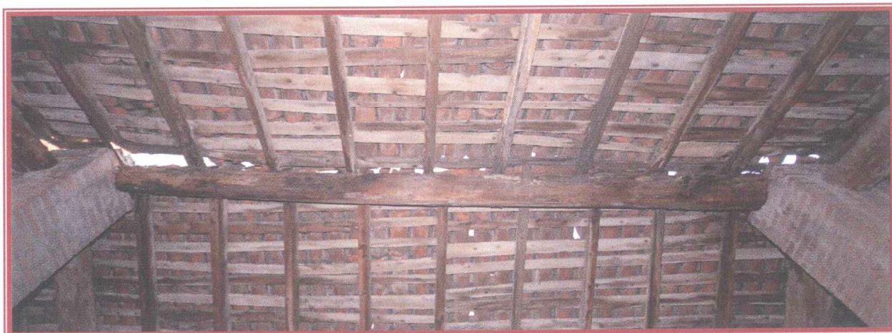
Figura 22 Trave del tetto danneggiata dalla perdita di acqua del manto di copertura.
