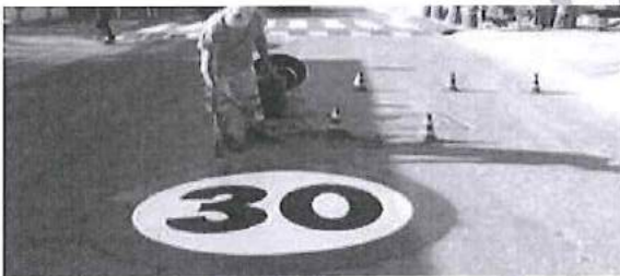
Segnaletica ordinaria e speciale
