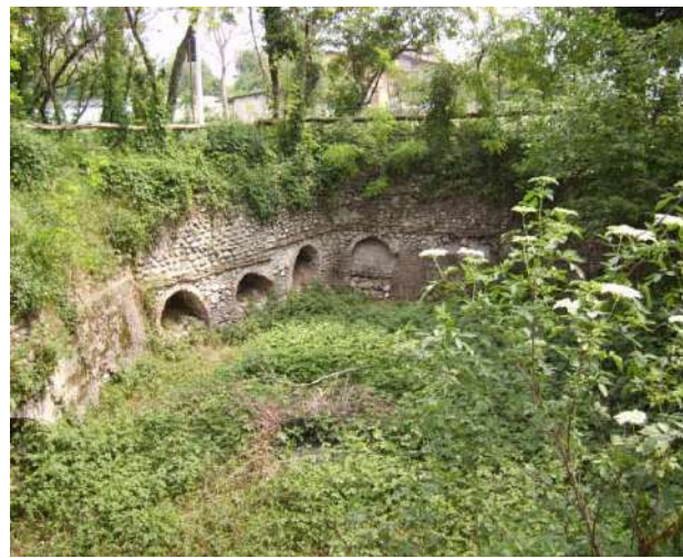
Capofonte con struttura ad archi in laterizio e muro di contenimento in borlanti di fiume (foto Beretta).
