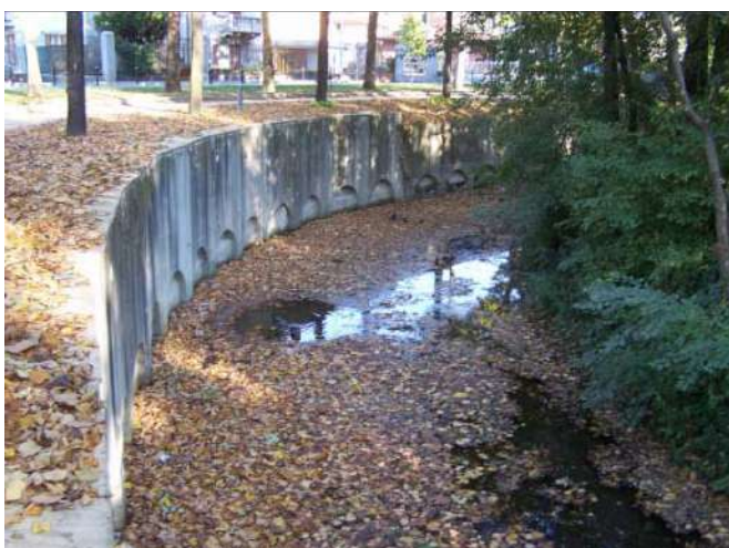
Muro di contenimento in cemento a nord del fossato con motivi ad arco (foto Arzuffi).
